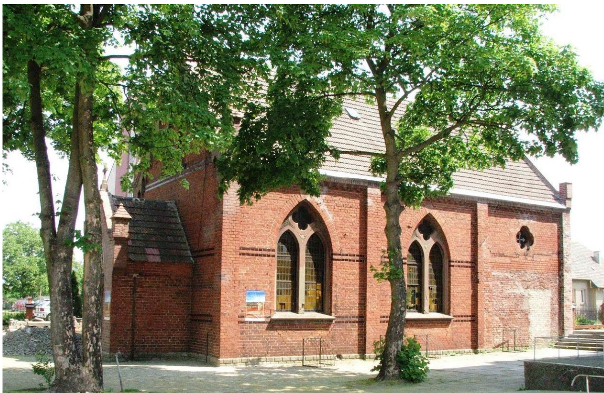
Nieciekawy stan budynku niedługo przed rozpoczęciem remontu. Archiwum Urzędu Miasta.
