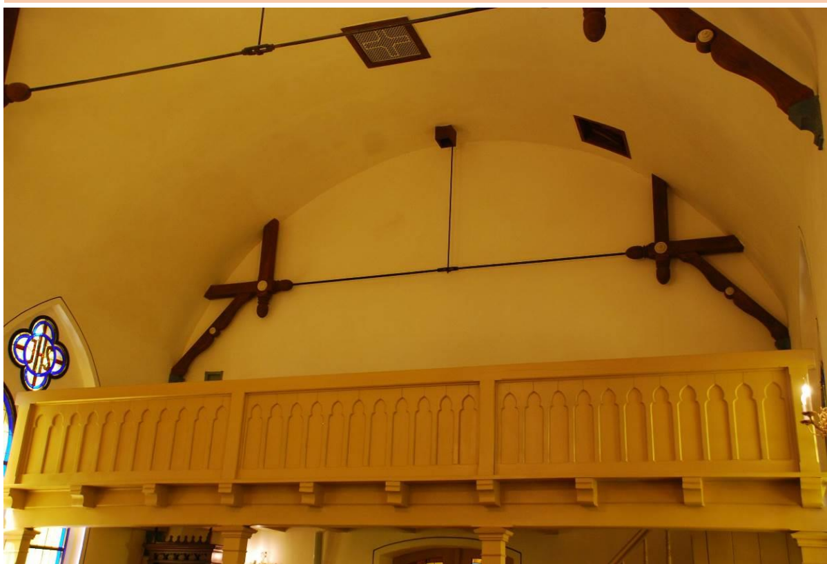
Odrestaurowany drewniany neogotycki chór. Powyżej odnowione fragmenty konstrukcji więźby dachowej. Fot. Małgorzata Jaraczewska–Dreger.
